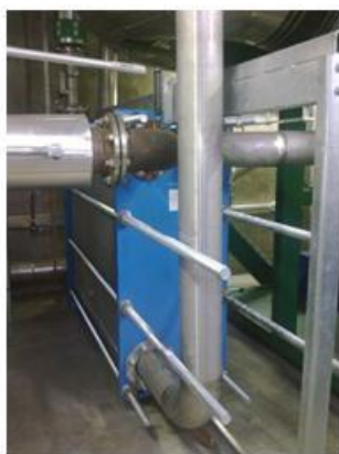
VVX rökgaskondensat till fjärrvärmereturen
