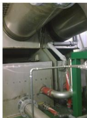
VVX rökgaskondensat till fjärrvärmereturen
